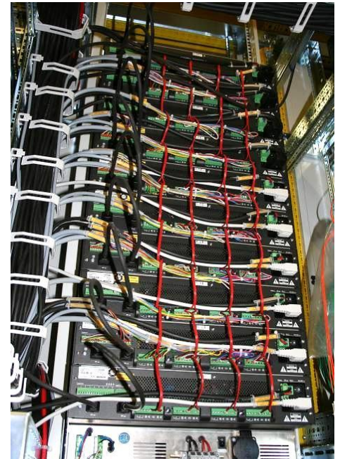
Installatie met reserveversterker en noodvoeding (onderaan), data en audio met optische verbindingen in lus bekabeld
